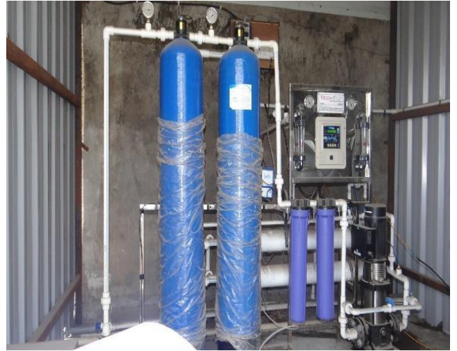
R. O. Plant
